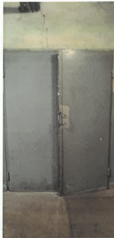
6. wejście korytarz szaf zasilających
