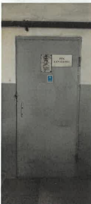
7. pomieszczenie rozdzielni RG
